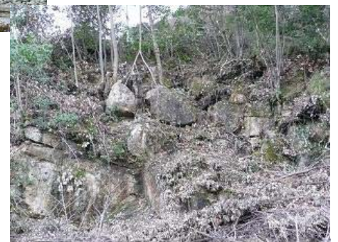
まだまだ危険な箇所
