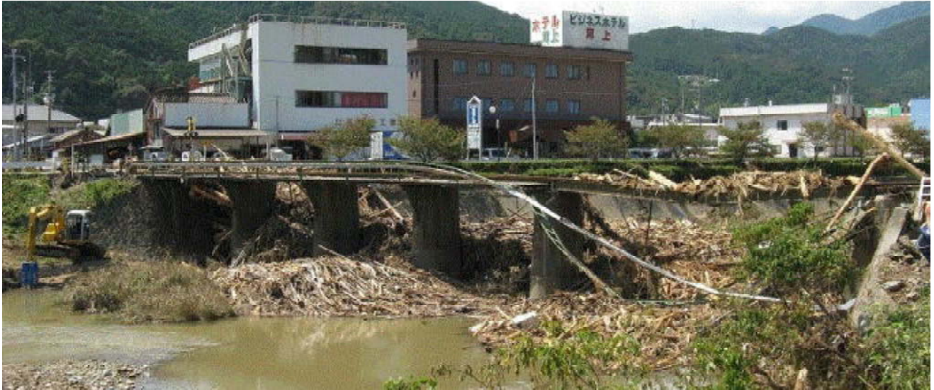
【台風12号により被害を受けた『熊野市駅構内の井戸川に架かる鉄橋』】
